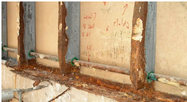
Проржавевшие стальные шпильки и профили в наружной стене многоквартирного дома, проходящего полный ремонт ограждающих конструкций, находятся в климатической зоне 4 в результате попадания воды в стеновой узел, где низкий потенциал высыхания.
