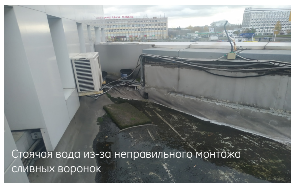
Протечки, в связи с некачественным ремонтом
